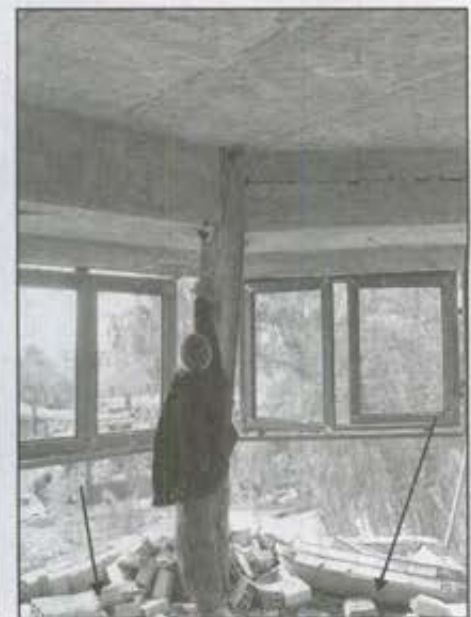
تصویر شماره ۲۳: کماتش ستون مهار مناسب پنجره و مهار نامناسب دیوارها
