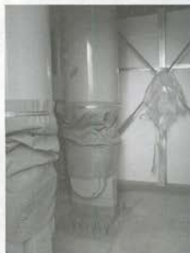
شکل ۵: تصویر میراگرهای نصب شده
