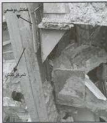
تصویر شماره ۱۱: گسیختگی پلیت باد بند و تیر از ستون
