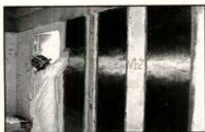
شکل ۱۸: دیوار آجری تقویت شده با [۱۳، ۱۴] FRP
