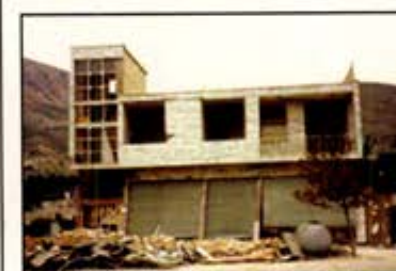
شکل ۹-ب: نامنظمی در ارتفاع و ایجاد طبقه نرم [۲]
