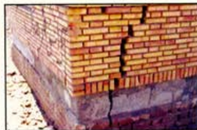
شکل ۱۰-ب: مکانیزم آسیب در تقاطع دیوار محصور [۱۱] خرابی ناشی از برش که با ترک‌های مورب
