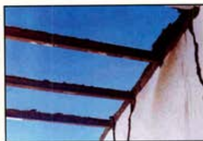
شکل ۷-ب: آسیب ناشی از قرار داشتن مستقیم تیرهای دال روی دیوار [۲]
