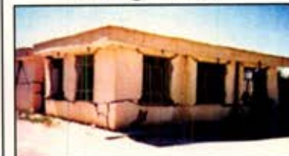
شکل ۶-ب: نوع آسیب و ترک در جرزهای بلند [۳]
