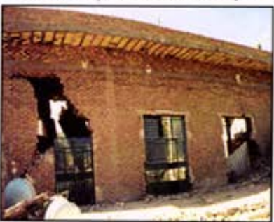
شکل ۴-پ: آسیب ناشی از دیوار با ارتفاع زیاد [۱]
