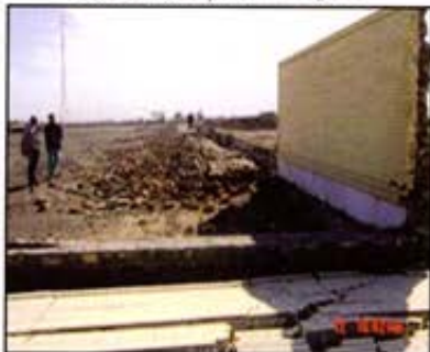
شکل ۴-ب: آسیب ناشی از عدم کنترل طول آزاد
