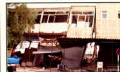
شکل ۹-الف: نامنظمی در ارتفاع و ایجاد طبقه نرم [۲]
