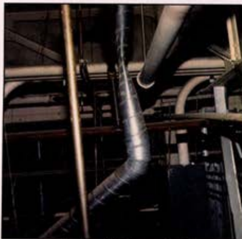
شکل ۳: آسیب‌دیدگی لوله در اثر برخورد
