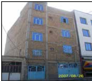
ساختمان مسکونی با اسکلت بتنی و نمای رها شده
