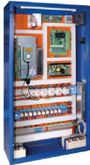
شکل ۱-۲: تابلو فرمان آسانسور مجهز به سیستم 3vf
