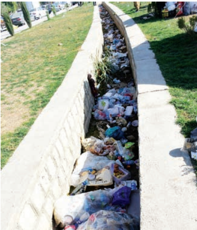
شکل ۱۵: انباشت زباله - سرپل ذهاب
