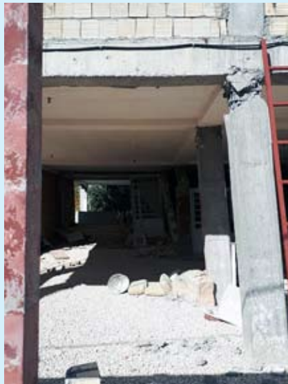
شکل ۴-۱۱- تشکیل مفصل پلاستیک در ستون
