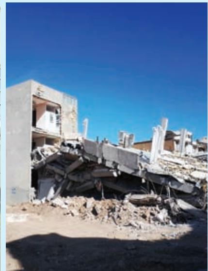
شکل ۱-۴- مقایسه اجرا صحیح با اجرا غلط ساختمان تخریب شده
