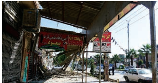
شکل ۱۴: سقوط مصالح به مسیرهای پیاده - سرپل ذهاب
