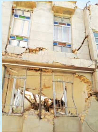
شکل ۲-۴- عدم وجود کلاف بندی قائم و افقی مناسب
