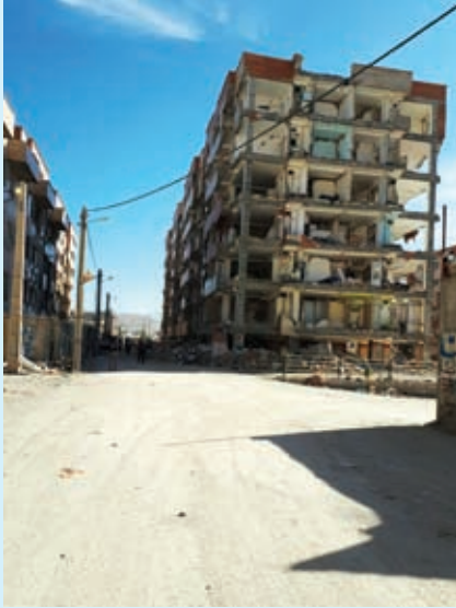
شکل ۴-۹- عدم اجرای کلاف بندی مناسب برای دیوارهای غیر سازه‌ای
