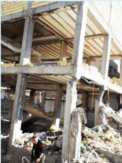
شکل ۴-۱۲- عدم رعایت درز انقطاع و ضربه زدن به ساختمان مجاور
