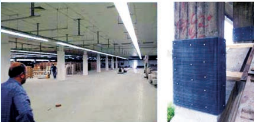
تصویر ۱۷- نحوه کفسازی و نفوذ ملات با فناوری داکان ماخذ: www.ducon.eu تصویر ۱۸- پوشاندن و تقویت پایه های پل با ژاکت داکان - آلمان تصویر ۱۹- محصور کردن صد ستون در تسهیلات صنعتی واقع در منطقه زلزله خیز - ترکیه ماخذ: Hafmann, P, 2011, 40-45
