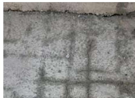
تصویر ۱۸- ترک های چندوجهی انقباضی از نوع نشست پلاستیک روی بتن جوان فونداسیون
