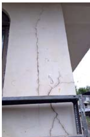
تصویر ۱۱- ترک های عمودی ناشی از خوردگی میلگردهای ستون در مناطق شمالی در یک مسجد
