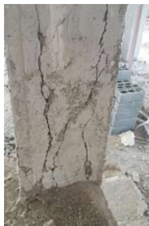
تصویر ۱۰- ترک های عمودی روی ستون بتنی ناشی از کم بودن ظرفیت باربری آن
