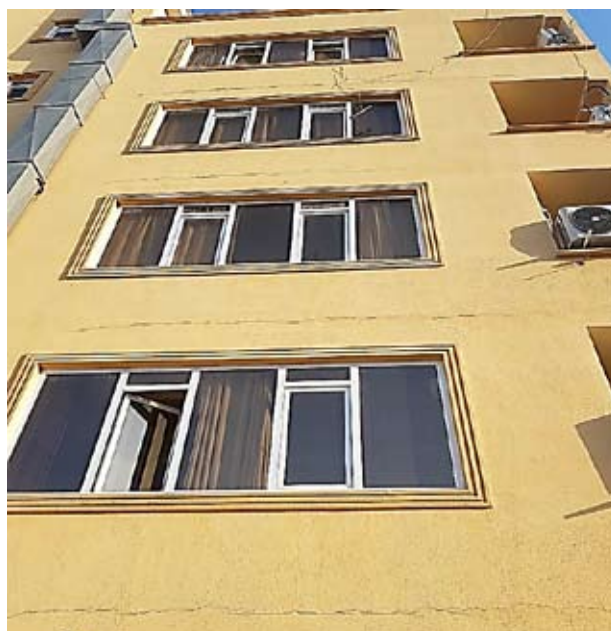
تصویر ۷- ترک های افقی مرز دیوار خارجی و تیر بتنی ناشی از حرکت رفت و برگشت سازه در زلزله خفیف
