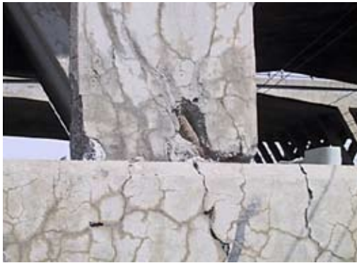
تصویر ۱۹- ترک های چندوجهی روی بتن، ناشی از واکنش قلیایی سنگ دانه پس از چند سال
