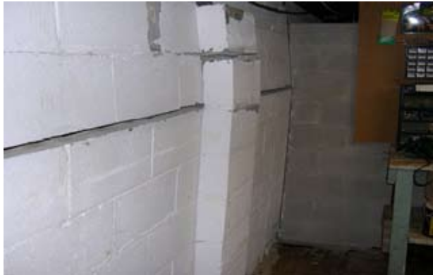
تصویر ۵- ترک‌های افقی ناشی از فشار خاک در زیرزمین
