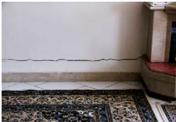
تصویر ۶- ترک افقی برشی ناشی از خیز تیر تحت بار متمرکز شومینه
