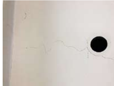
تصویر ۱۲- ترک‌های عمودی ناشی از انبساط مصالح مدفون در زیر پلاسترها
