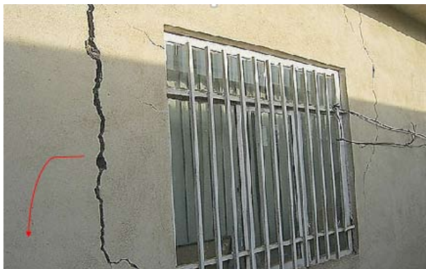
تصویر ۹- ترک های عمودی عمیق بعد از نشست یک طرفه خاک در زیر ساختمان
