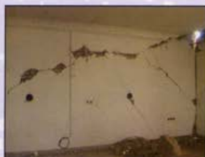
شکست داخل صفحه دیوار
