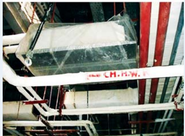
شکل ۹ نمونه‌ای از تأسیسات اجرا شده در پروژه بیمارستان سوختگی کرمانشاه
