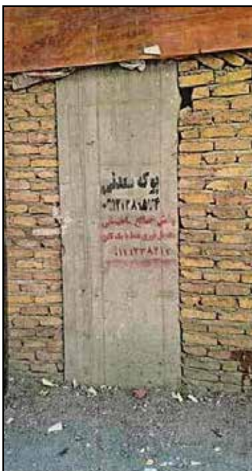
▲ عدم اجرای زیرسازی لازم (توری سیمی یا رابیتس کاری) دور ستون برای ایجاد چسبندگی ملات و اتصال سنگ
