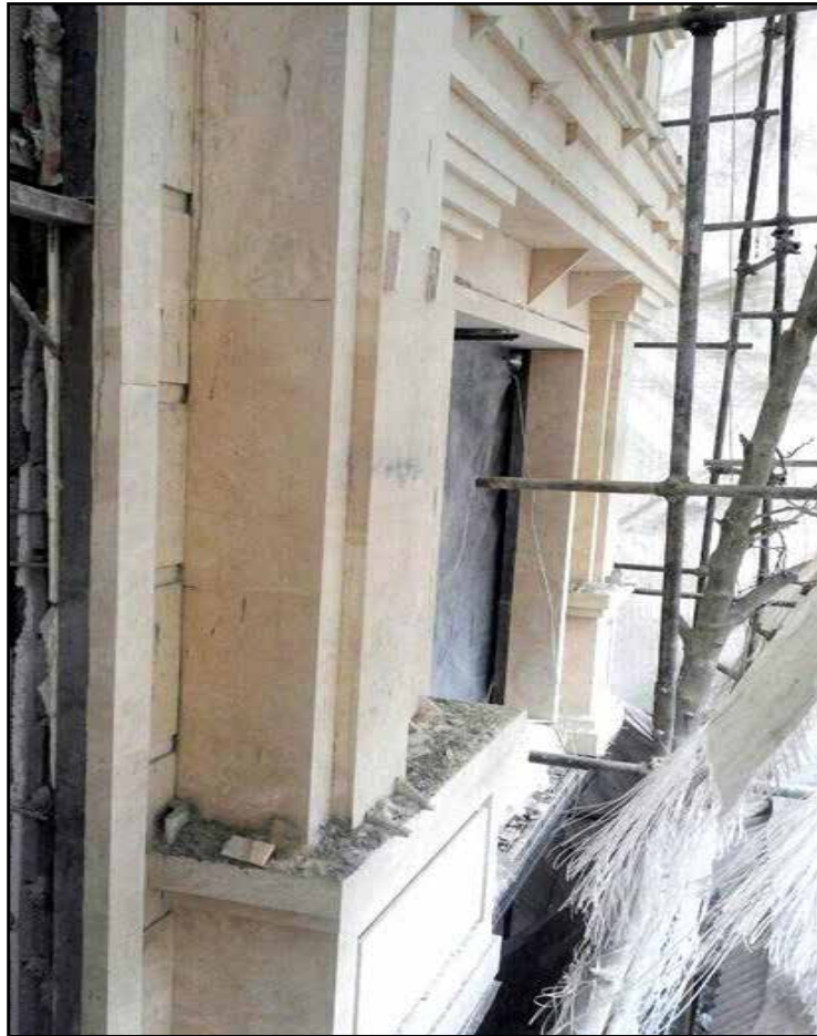
▲ احجام و پیش آمدگی بیش از ۱۰ سانتی متر؛ (به طور مثال در عکس حدود ۴۰ سانتی متر) بدون دیتیل اجرایی سازه نگهدارنده و اتصالات مناسب
