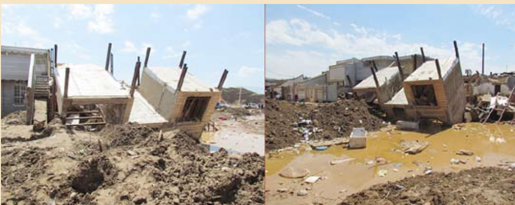
ب) تخریب سیل بند که در سیل سال ۹۵ بخشی از آن تخریب شده بود شکل ۵- بخشی از آسیب های مشاهده شده در شهرستان پلدختر
