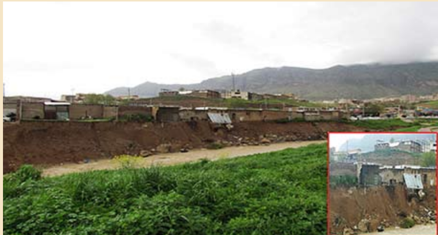
شکل ۱- ساخت‌وساز مسکونی در حاشیه مسیر بالادست رودخانه کرگانه که در جریان طغیان مسیل، موجب شسته شدن پی و تخریب بناها شده است
