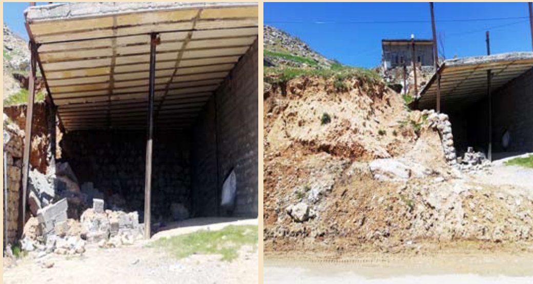
شکل ۱۱- اسکلت نیمه کاره فولادی که به واسطه رانش دچار آسیب شده است ۳-۴ جمع بندی آسیب‌های ناشی از سیل
