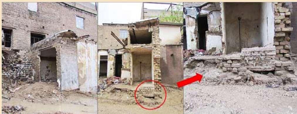
شکل ۳- آسیب به واحدهای مسکونی: گرچه به نظر می‌رسد هیچ‌یک از بناهای مسکونی برای بار سیل طراحی نشده است اما ساختمان‌های فاقد مشخصات فنی در مسیر سیلاب آسیب‌پذیرترند
