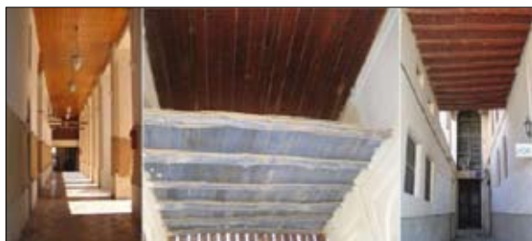
تصویر ۵- سازه چوبی، دولایه بودن، ارتفاع زیاد سقف
