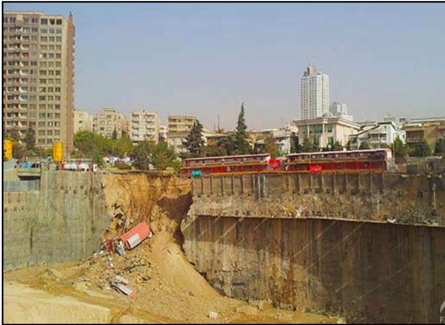
عکس شماره ۲: نمای قسمت ریزش کرده (۹۲/۷/۱۱)
