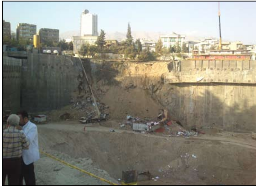
عکس شماره ۴: نمای قسمت ریزش کرده پس از ریزش کنترل شده (۹۲/۷/۱۳)
