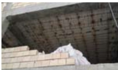
تصویر ۲۱- تخریب تیرچه پاشنه بتنی
