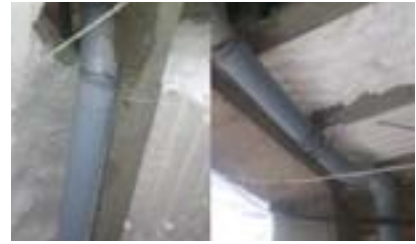
تصویر ۲۲- تخریب تیرچه پاشنه بتنی
