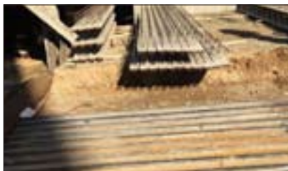
تصویر ۱۵- تخلف تولید تیرچه پاشنه بتنی در محل کارگاه ساختمانی
