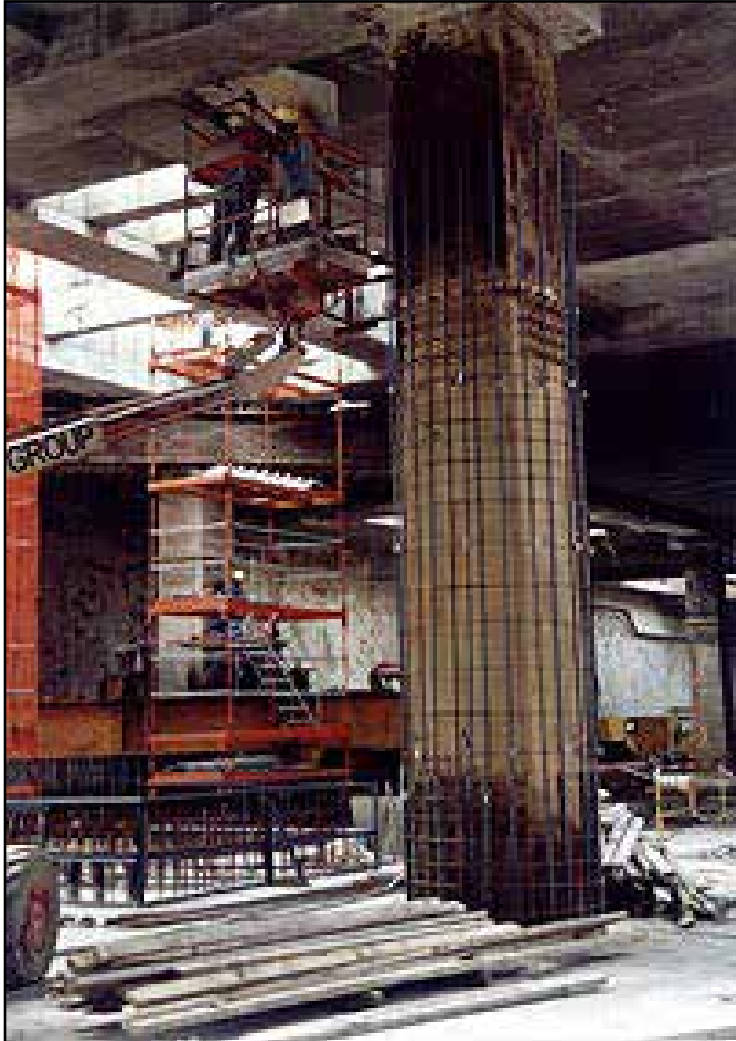
▲ اجرای فرآیند تاپ - دان در طبقات زیرزمین. شمع‌های فولادی که پیش از اجرای خاکبرداری نصب شده‌اند در این تصویر دیده می‌شوند که دال سقف‌ها را نگاه می‌دارد
